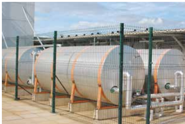
Tanques de água quente
