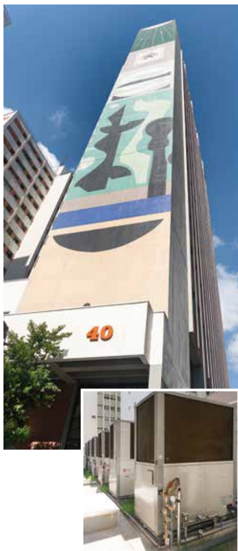
Condensadoras foram distribuídas ao longo dos andares
