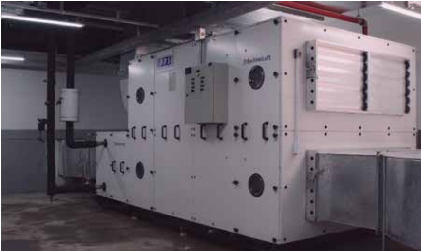
Unidades de tratamento de ar
