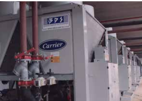
Bombas de calor para geração de água gelada e quente
