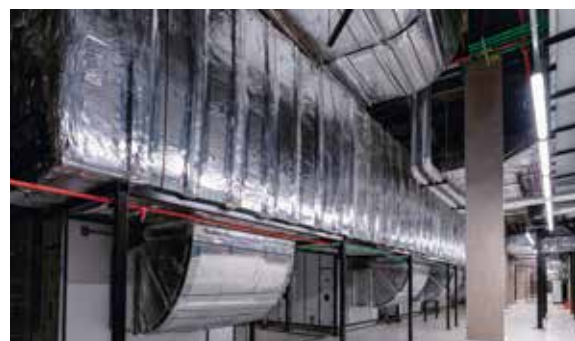
Unidades de tratamento de ar
