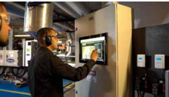
Painel de automação
