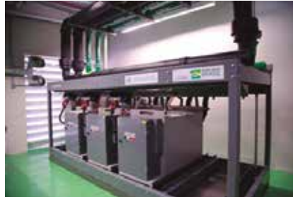
Figura 2: Chiller HC-290/glicol instalado em supermercado brasileiro
